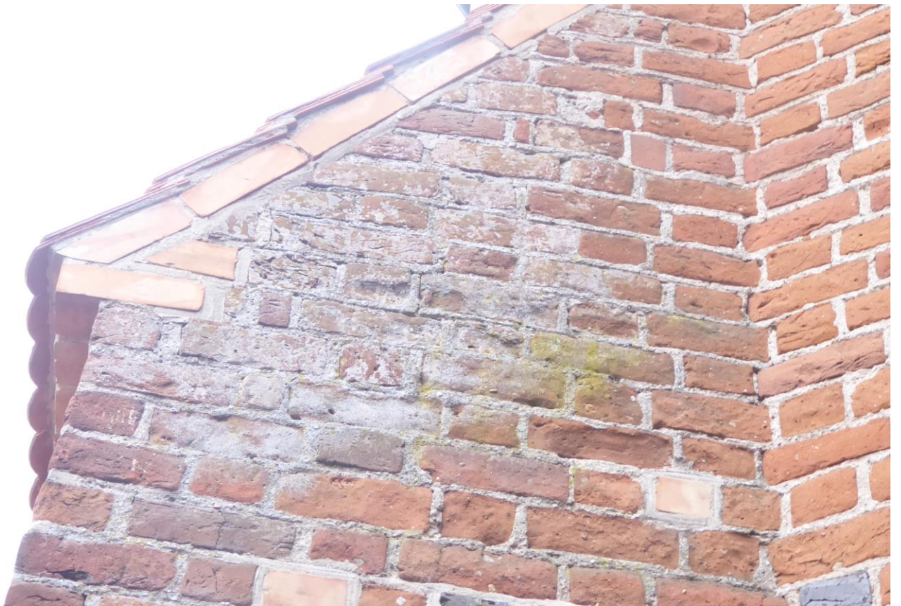
Fot.11. Nawarstwienia organiczne na spływowych częściach muru
