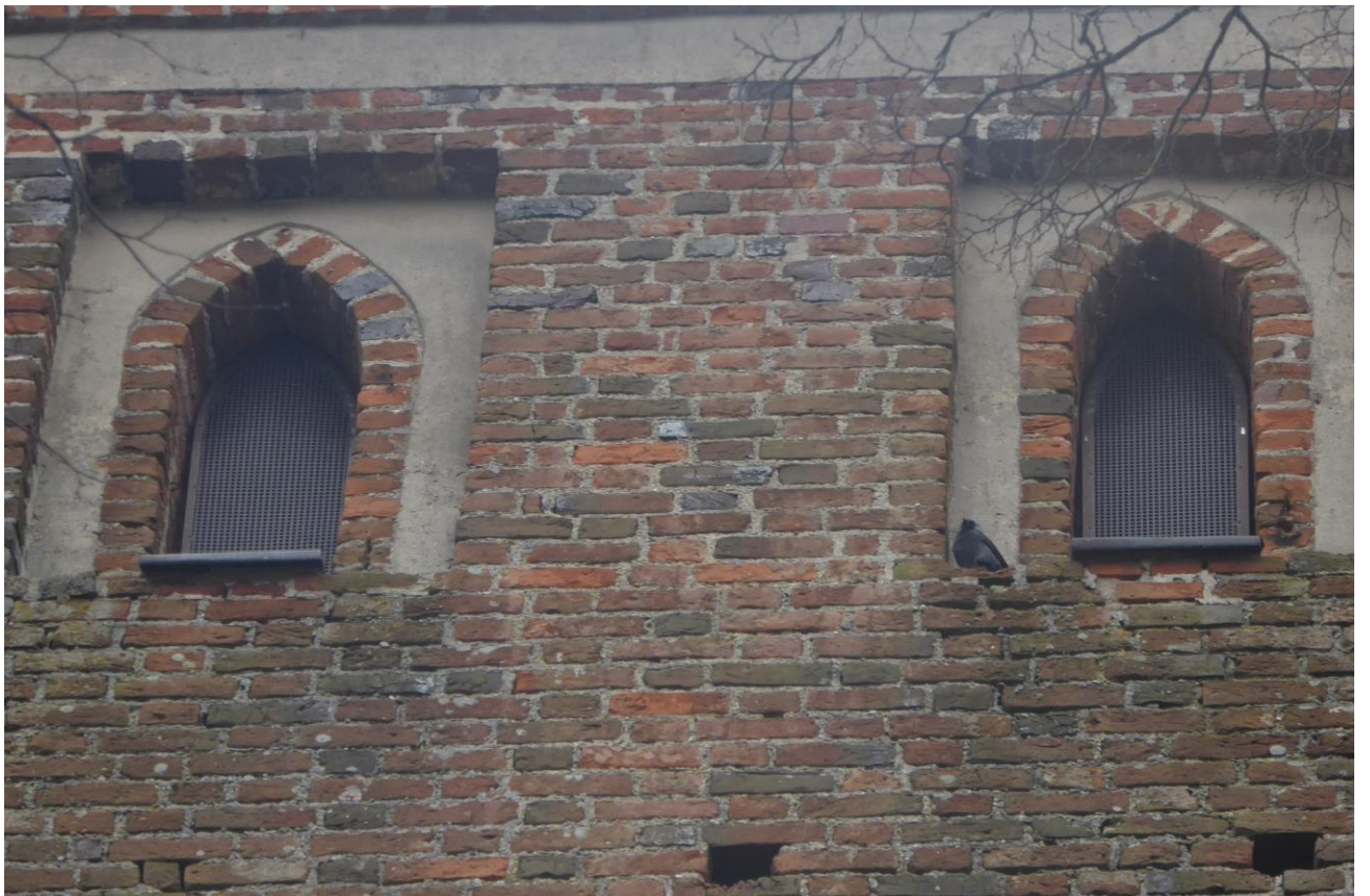
Fot.12. Szare i brunatne naloty na murach i tynkach
