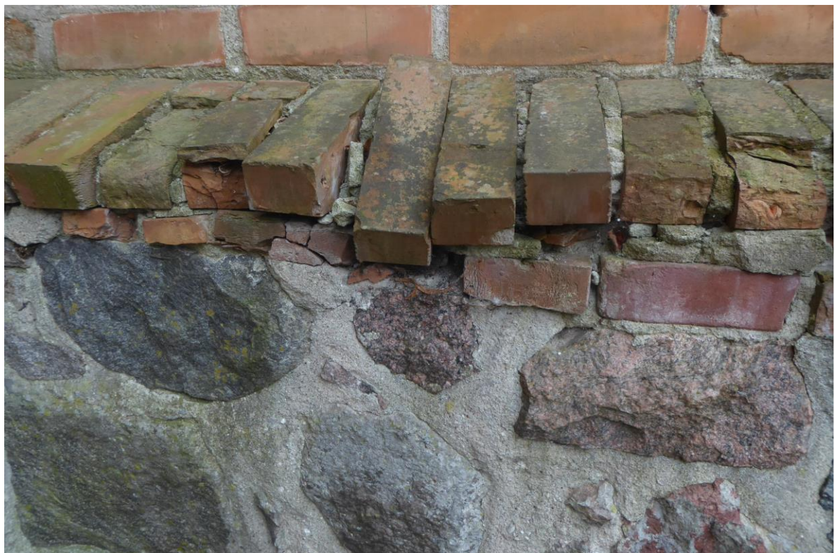
Fot.6. Uszkodzenia parapetu kamiennej ściany cokołowej
