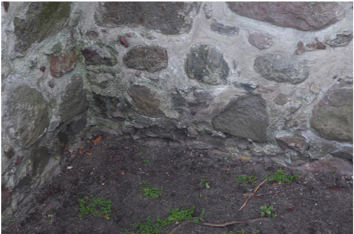
Fot.10. Cementowe spoiny wtórne na ścianie cokołowej
