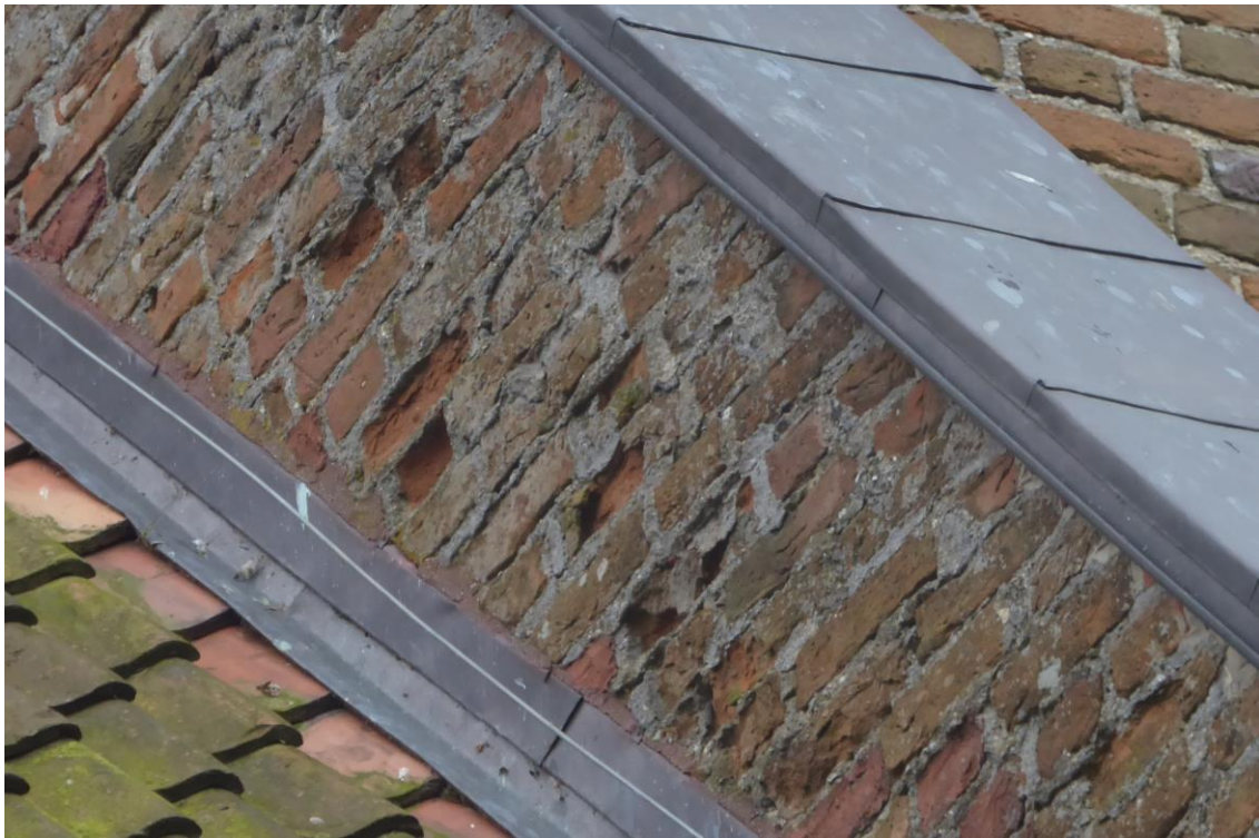
Fot.7. Uszkodzenia ściany – ubytki lic cegieł
